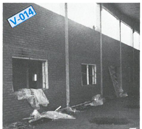
Väggen mellan hög- o lågdelen färdigmurad. Uppsättning av gipsskivor på vägg och tak samt resning av mellanväggar i lågdelen pågår.
