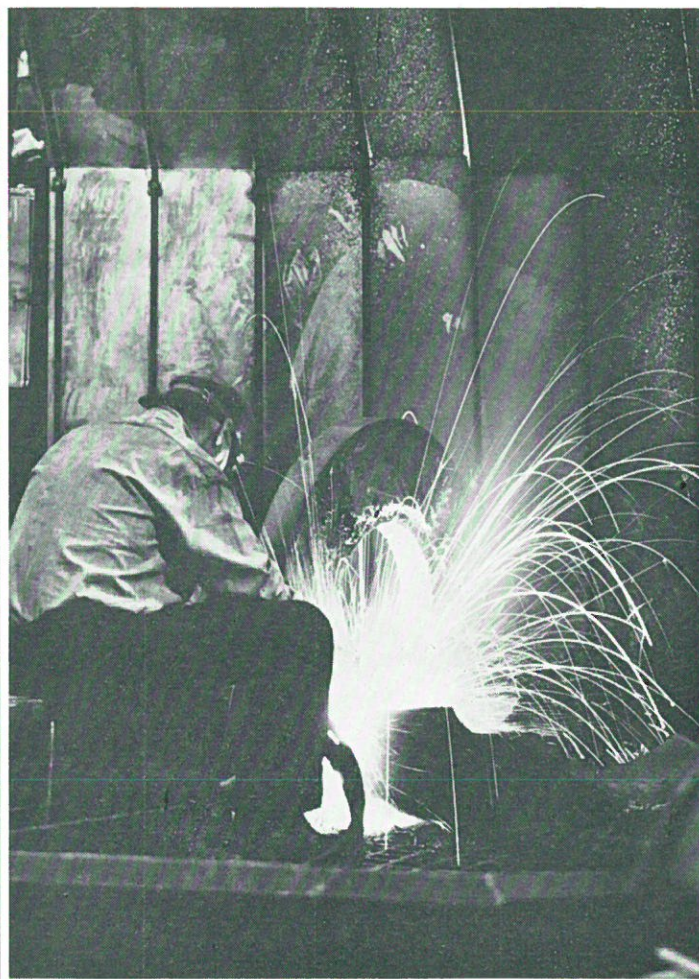
Pulverskärningen utvecklar ett intensivt "gnistregn". Utsugningen sker genom slitsarna i bakgrunden. Luftflödet är ca 18 000 m 3 /h.
