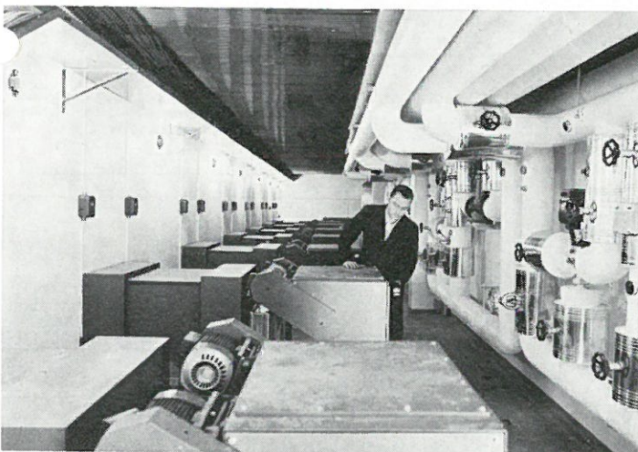
Av utrymmesskål har 7 av KSH-aggregaten "byggts genom väggen". Här är intagssidan där man ser fläktdelarna och ljuddämparna. Fläktdelarna är försedda med två motorer för fullt och reducerat luftflöde. Ett gemensamt tilluftsaggregat levererar filtrerad och förvärmad luft till samtliga aggregat.
